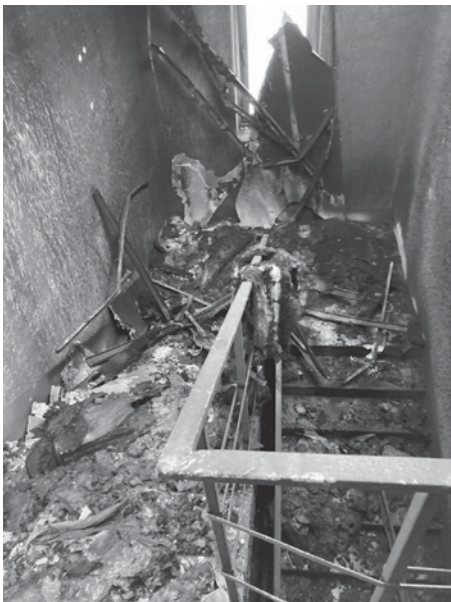
Зруйнована квартира зсередини, Ірпінь (березень 2022 р.)
